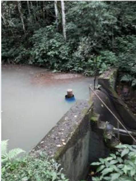
Figura 78 – Captação Superficial no Rio Panela
